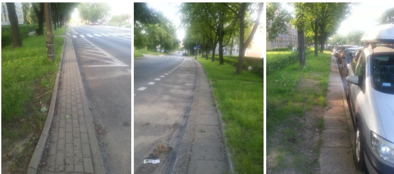
Przykładowe zdjęcia opaski zewnętrznej jezdni wykonane przy ulicy Czapli w Gliwicach.
